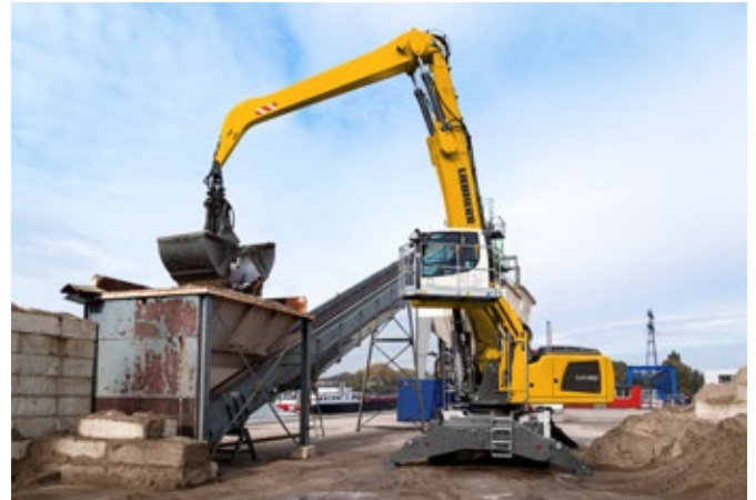
Alimentación de una planta de hormigón con la LH 40 M Industry Litronic
